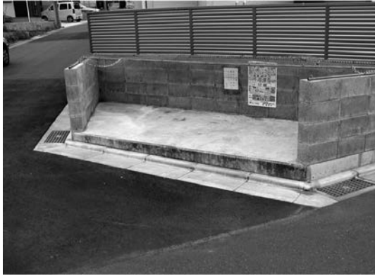
写真-3 ゴミ置き場の事例（隅切り部） 3)
