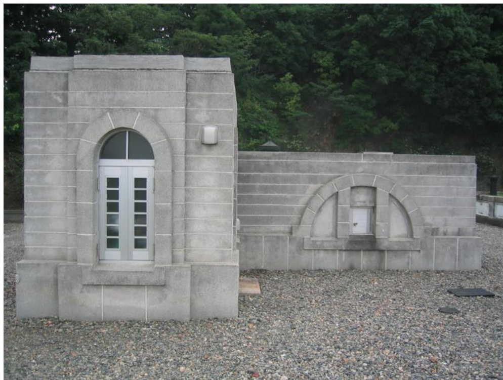
RC造（ろく屋根）、塩素滅菌室付、面積43㎡
