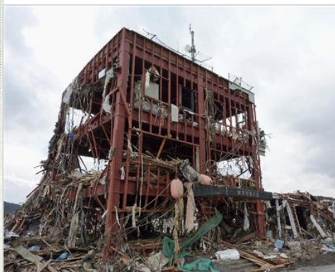
被災した防災対策庁舎
