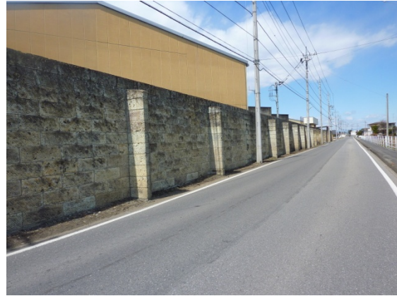
No. U-2 (宇都宮市石井町) 無被害 高さ 3.3 m・鉄筋なし 60～70 年前竣工
