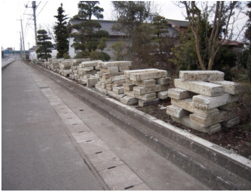
基礎に縦筋は見られない
