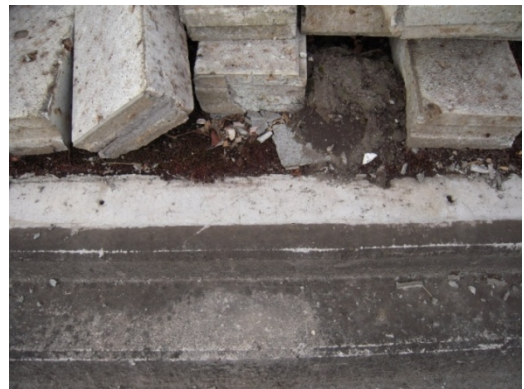
基礎部の縦筋なし モルタル付着なし
