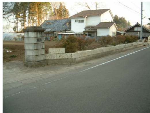
No. M-7（真岡市下籠谷） 全倒壊 高さ 1.75 m・鉄筋なし
