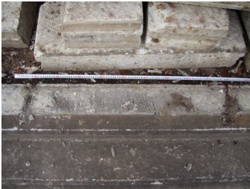
基礎部の縦筋なし
